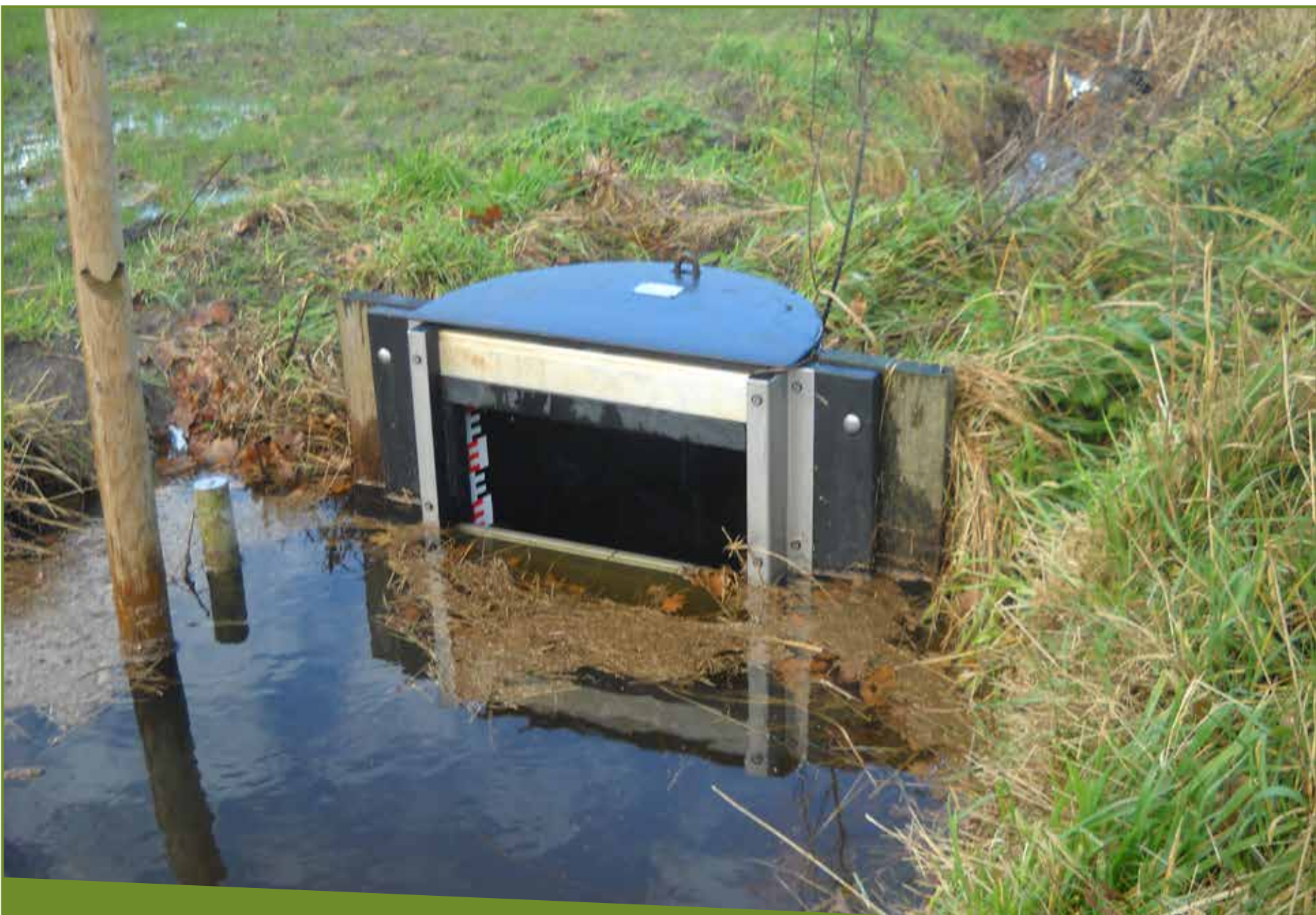
regeling grondwaterpeil met schotbalkstuw
