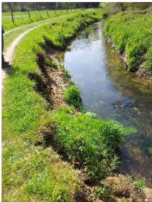
Foto's boven: IJse tussen het kasteel van Neerijse en monding in de Dijle; de weg wordt aangevreten door de waterloop
