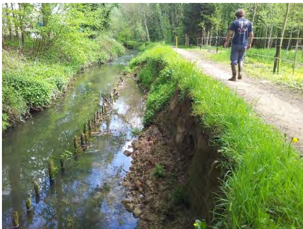
Foto: afkalvende oever van de IJse naast het pad
