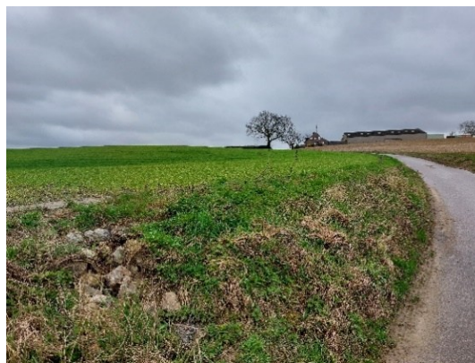
Figuur V-59: Geërodeerde talud onderaan de Sint-Martinusweg
