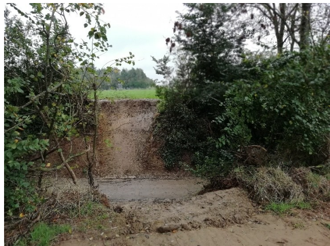
Figuur V-89: Beschadiging aan de houtkant/holle weg door recreatiedruk
