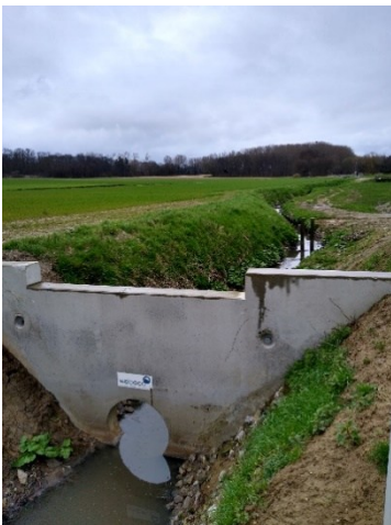
Figuur V-98: Bestaande knijp aan het bufferbekken van Infrabel
