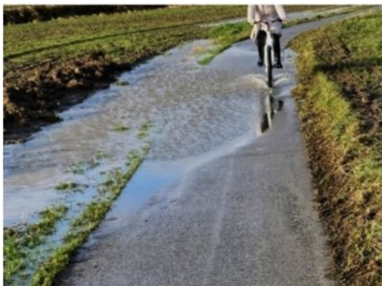
Figuur V-85: Probleem van modder- en wateroverlast op fietspad Noskoempad
