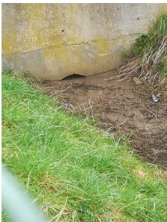
Figuur V-58: Verstopping afvoerbuizen regenwater door modder vanuit de erosie uit de hellende percelen.
