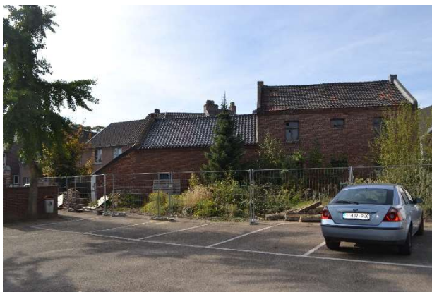
Figuur 17: Vervallen woning aan de Bergplaats
