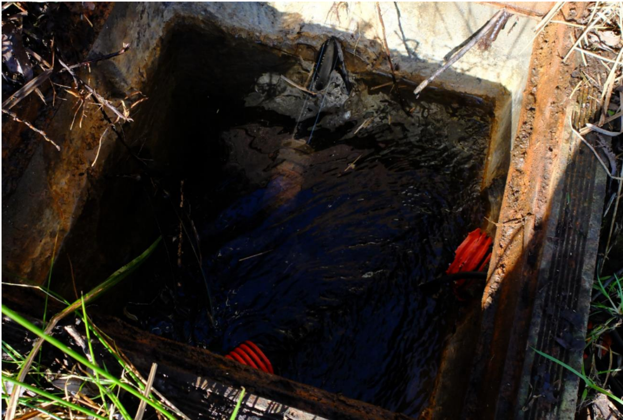
Fig 2.14 Collectorput waarin de drainagebuis afwatert
