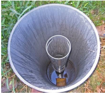
Figuur 33 Regelput verbonden aan een moerdrain ter omvorming van klassieke drainage naar peilgestuurde drainage. De binnenste buis fungeert als regelklep met overloop.
